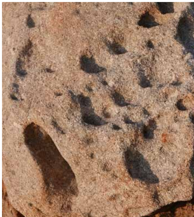
Figura 44 – Alveolizzazioni per alterazione meteorica – ph M. Bastogi
